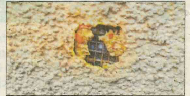
Paintball-Schaden. Foto: privat
